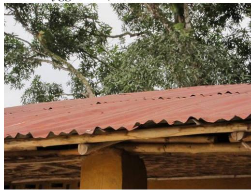
Det rostiga taket, som sedan byttes ut.
