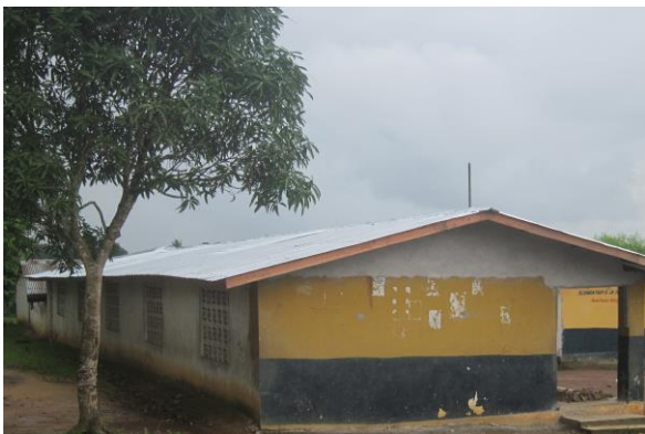
Taket på skolan Dominic Hena har bytts, efter att ha läckt på många ställen.
